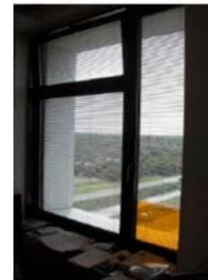
For at minimere varmetilskuddet fra solstråling og direkte sollys er der opsat udvendig solafskærmning omkring vinduerne.
