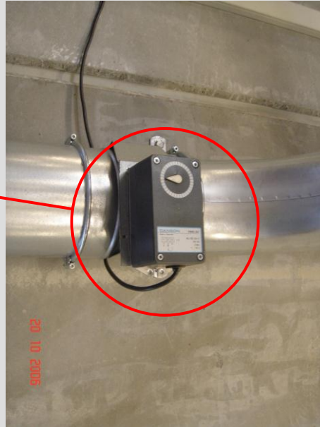
Figur 8.4. Afspærringsspjæld ved punktudsug
