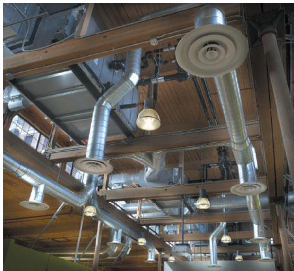
Figur 6.34. Indblæsningsarmaturer (spaltdiffusorer) til opblanding
