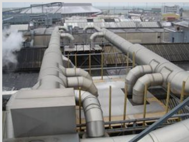
Figur 7.2. Udsugningskanaler på taget ovenover tørremaskinerne
