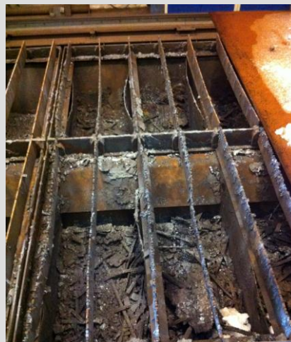
Figur 6.29. Udsnit af et gammelt skærebord. Metalaffald fra skæreprcessen dumper ned mellem de vandrette metalbjælker og ødelægger på sigt delvis udsugningsspjældene. Metalaffaldet skal fjernes manuelt.
