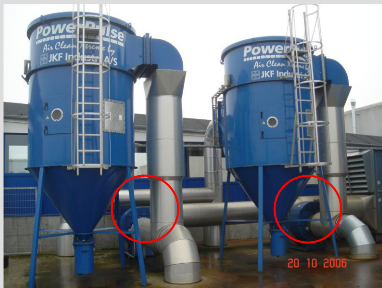
Figur 8.2. På billedet ses de to udsugningsventilatorer (røde cirkler) og de to cyklonfiltre
